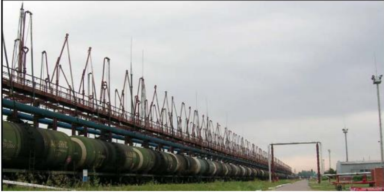
Şək. 1.7. Neftin dəmir yolu sisternlərinə doldurulma məntəqəsi
