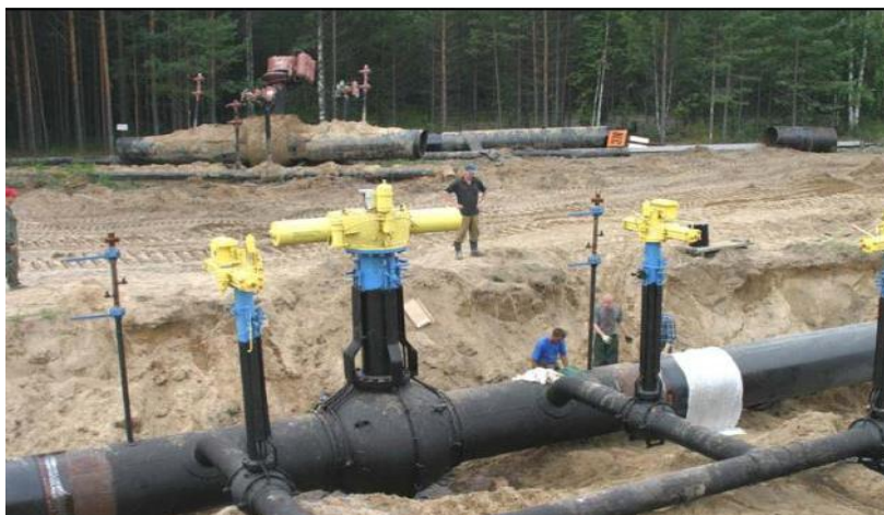
Şək. 1.18. Xətti kran qovşağı
