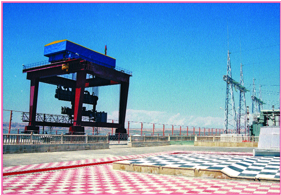
Şəmkir, Su-elektrik stansiyasından görüntülər.
