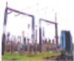
Elektrik paylayıcı stansiya
