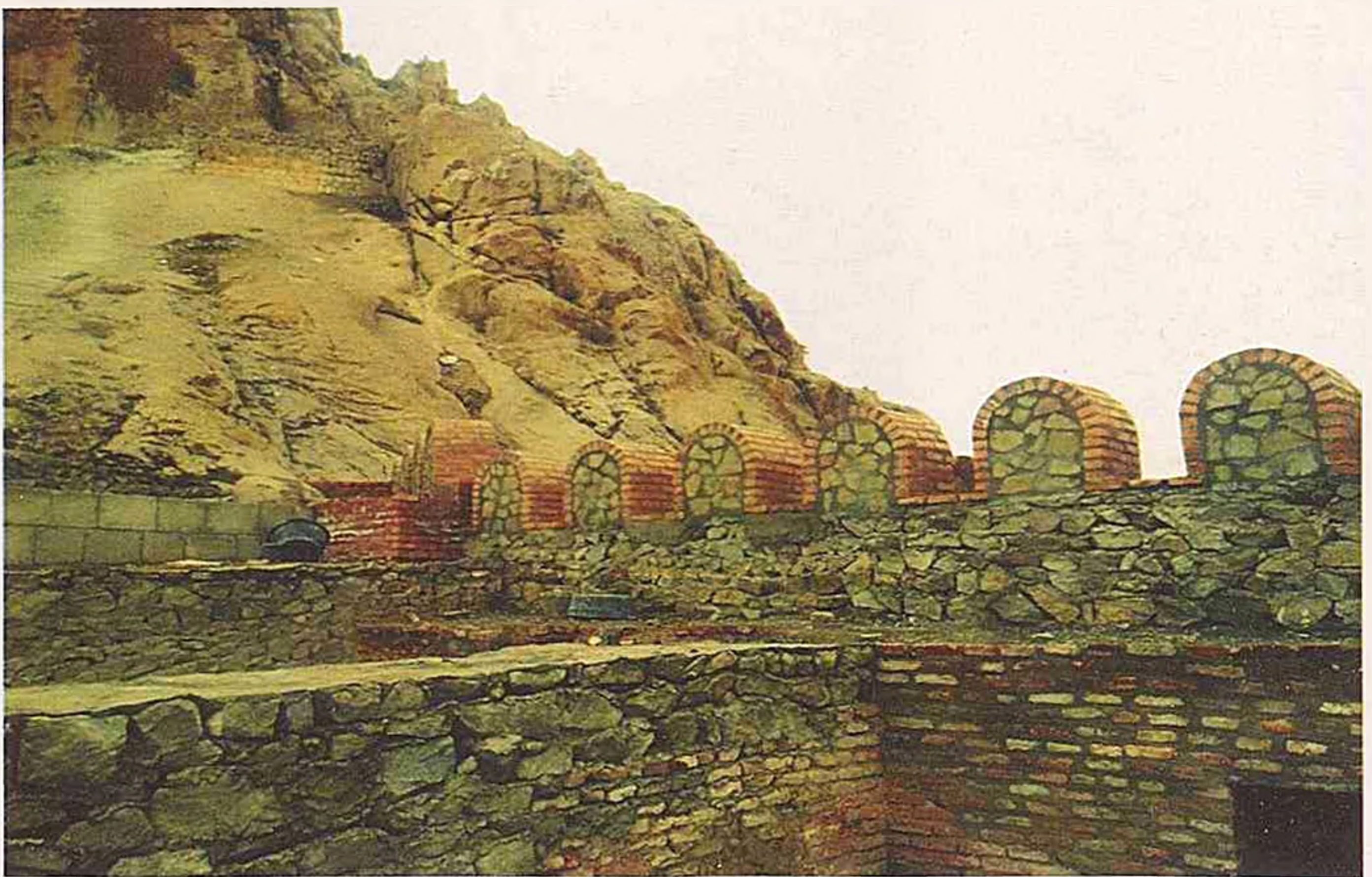
Şəkil 24. Qalanın şərq qapısında bərpa işləri. Рисунок 24. Реставрация восточных ворот крепости. Picture 24. The restoration of the eastern fortress gate.
