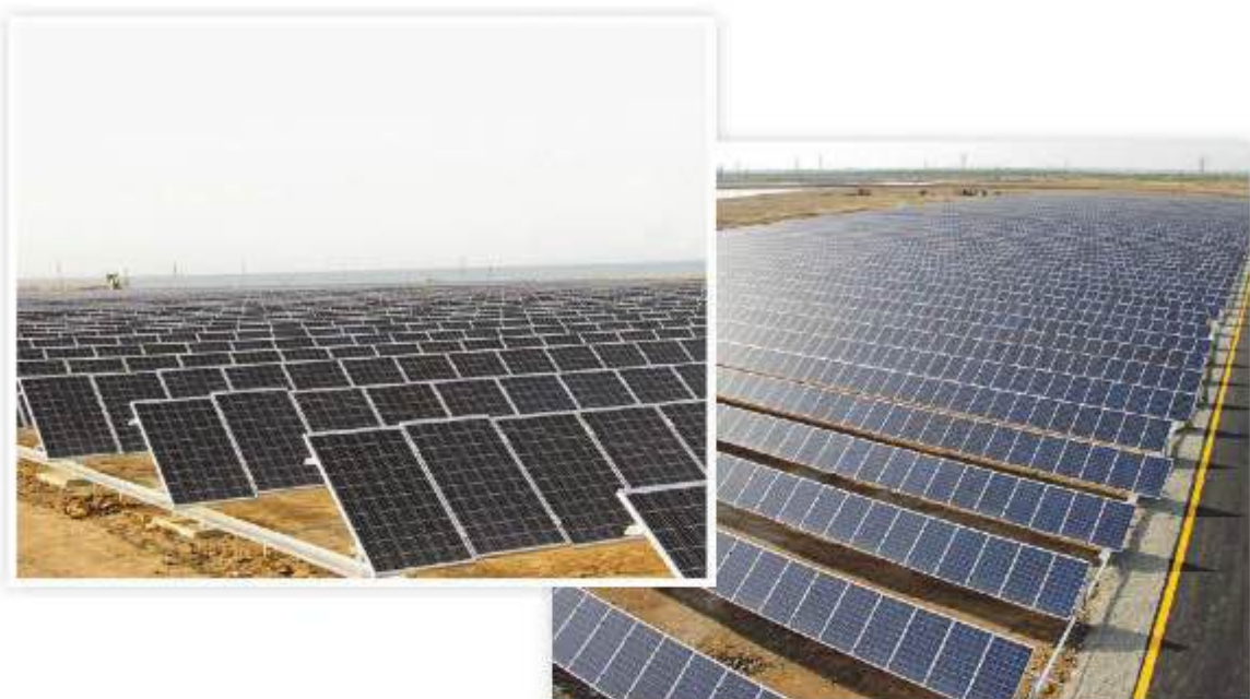
Şəkil 12.21. Pirallahı (2.8 MVt) və Suraxanı (2.8 MVt) Günəş Elektrik Stansiyaları
