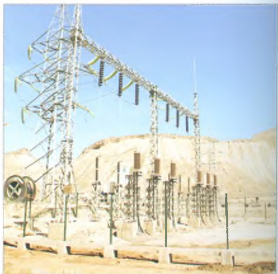
110/10-10 kV-luq “NORM” sement zavodunun YS-ı yanında EVX-KX-nə keçid məntəqəsi
