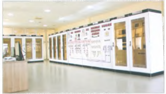
Yarımstansiyanın idarəetmə mərkəzi
