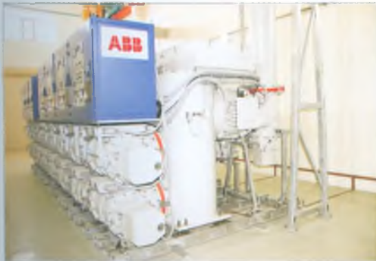
110 kV-luq GIS sistemi
