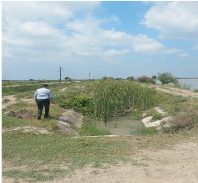
Şək 3.13. Suvarma kanalı və kollektor, Şəfəq SİB, 2014
