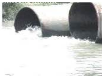
“8-ci km” qəsəbəsinin leysan suları kollektoru
